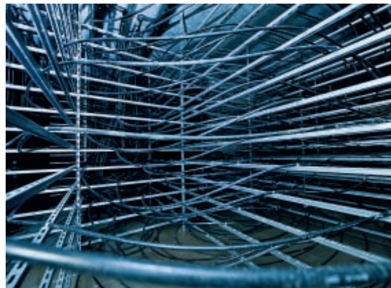
Kompliziertes Innenleben des Eisspeichers einer Klimaschutzsiedlung in Köln
